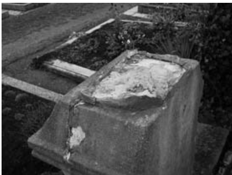
▲ Poškozené hroby na hřbitově v Albrechticích nad Orlicí
